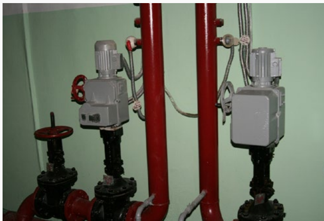
Система пожаротушения ГЭС
