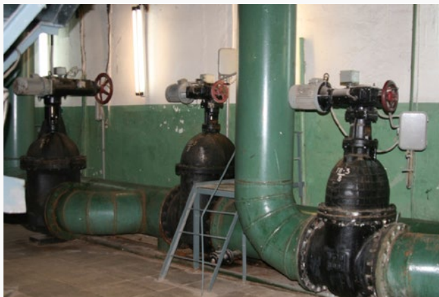
Насосная ТВС (Техническое водоснабжение для охлаждения гидроагрегатов)
