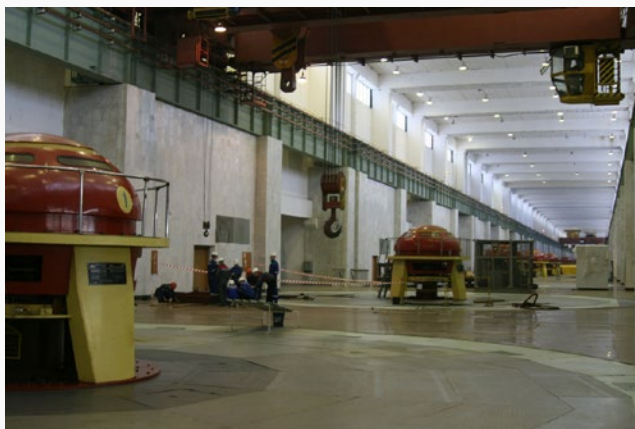
Машинный зал, где размещены гидроагрегаты
