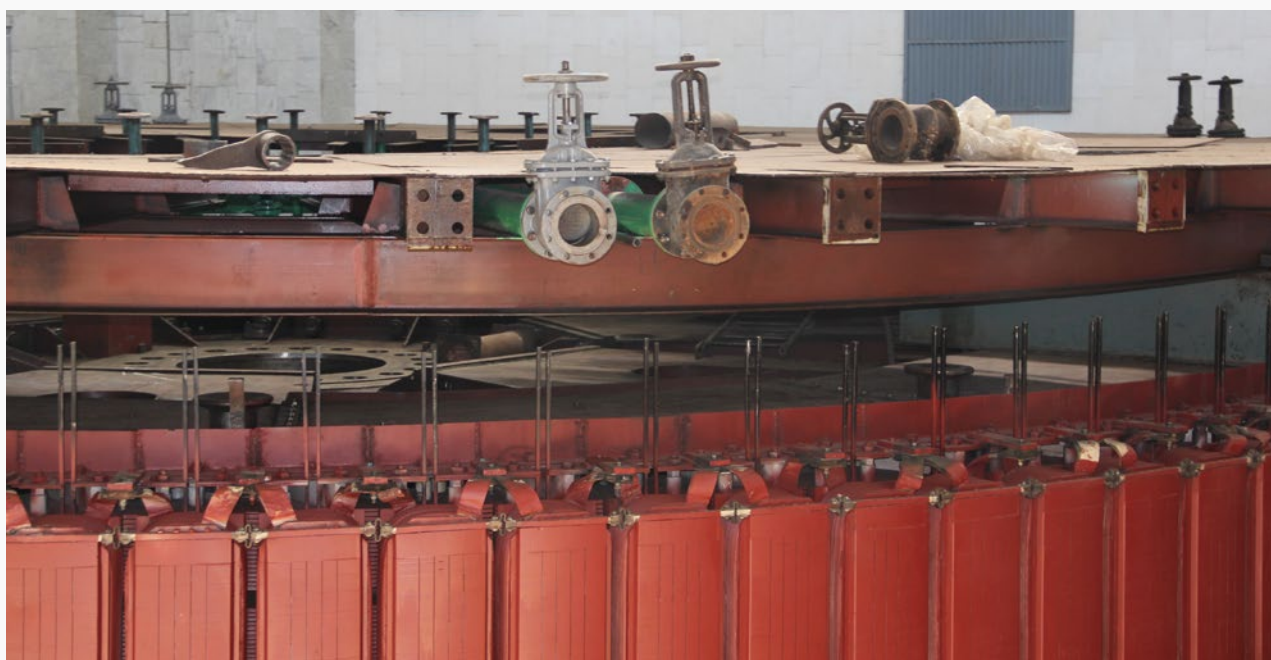
Задвижки на системах охлаждения гидроагрегата
